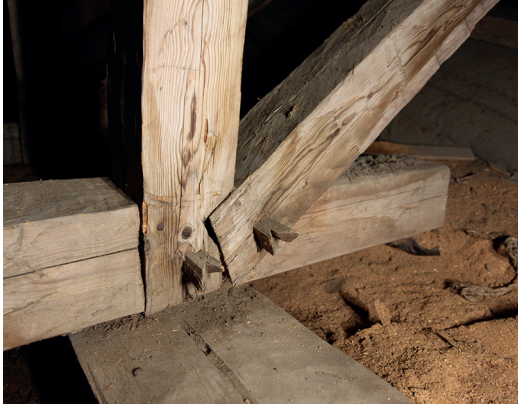
Kuva 6. Konttipuun ja saksen tapitettu lapaliitos alapaarteeseen on tehty romaanisen kattotuolirakenteen mukaisesti, eikä vesikattorakenne tukeudu konttipuun alaosaan jalasparrun tai muurin kylkeen. Rakenne mahdollistaa myös laipiolaudoituksen naulaamisen suoraan alapaarteeseen. Liitoksessa tapeissa on erityisen kauniisti viimeistellyt kannat. Kuva: Pauliina Saaren.
