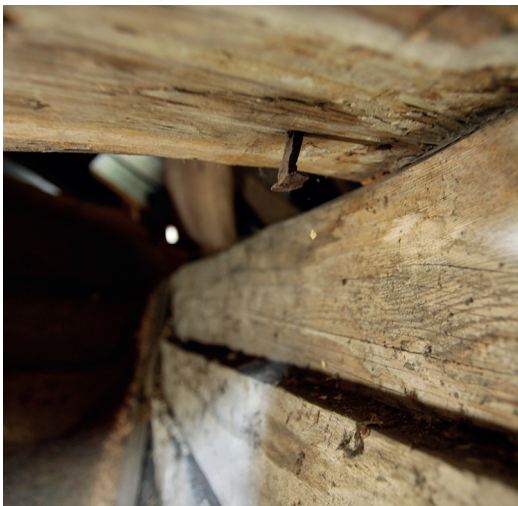
Kuva 7. Laipiolautojen kiinnitysnauloja on jäänyt alapaarteiden alapintaan. Kuva: Panu Savolainen.
