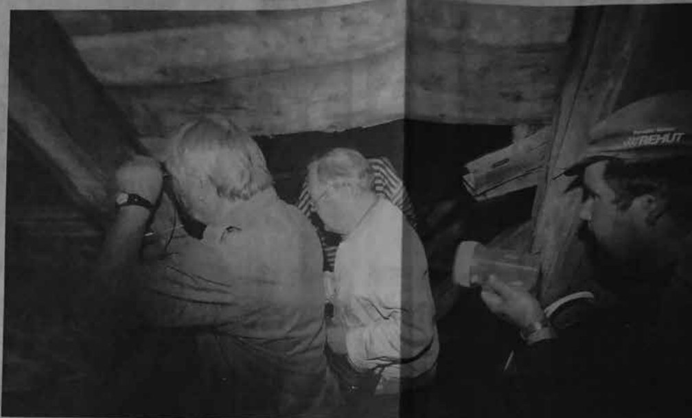
Jälkiä tuhoisista kuoriaisista on etsitty kiihkeästi kirkon katon kantavista rakenteista.
