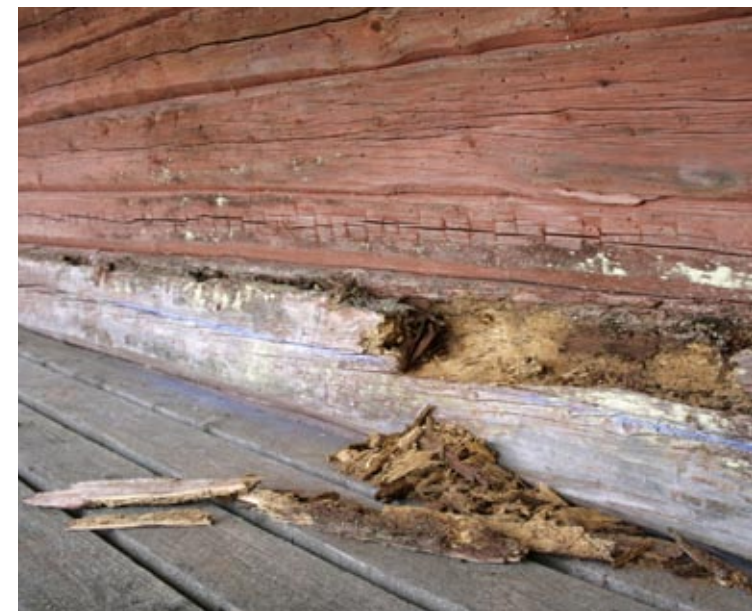
Länsisivun toiseksi alin hirsi osoittautui läpilahoksi eikä suunniteltua paikkausta siksi suoritettu. Hirsi on vaihdettava kokonaan.
