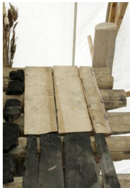
Jatkettuja räystäslautoja länsipäädyssä.
