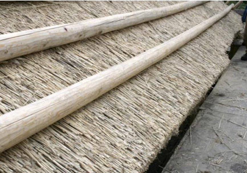
Kattotöiden aikana rannanpuoleinen räystäs pääsi valumaan alas reilut kymmenen senttiä.
