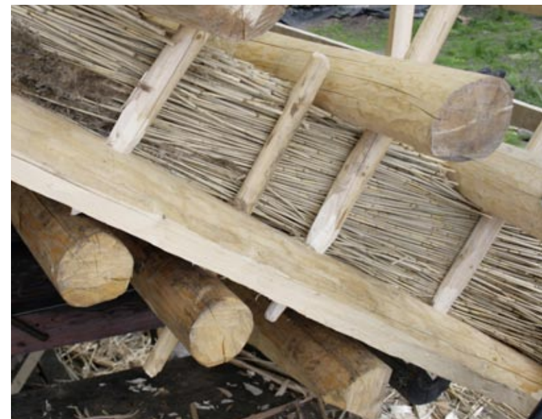
Jos yksikään maassa valmiiksi poratuista rei'istä ei osunut sopivasti vuoliaisen kohdalle, tehtiä katolla ylimääräinen reikä lyhyempää sarvilaudan kiinnitystappia varten.
