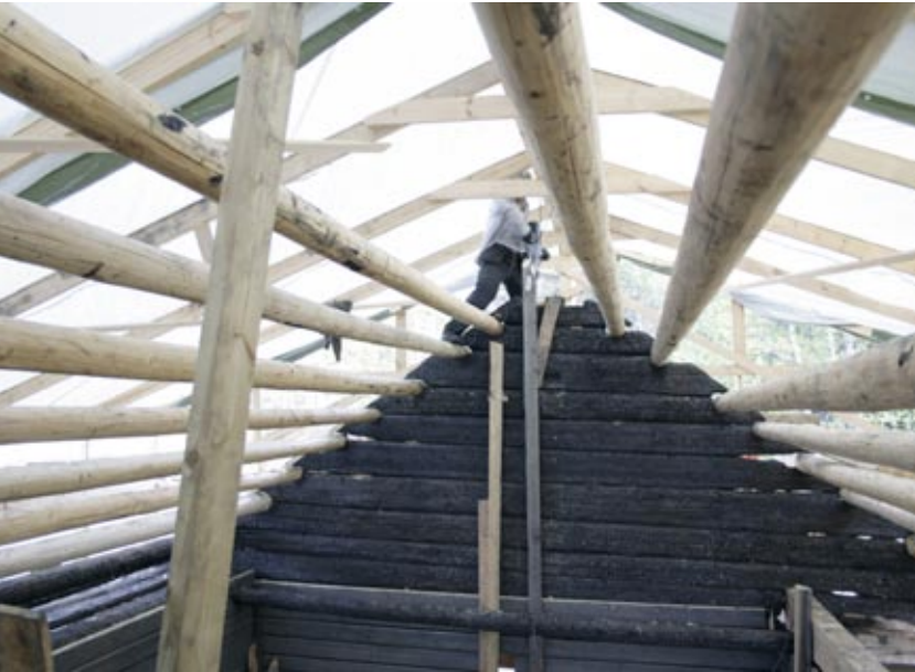
Päätyjen hirsien varaukset ja salvaimet olivat vaurioituneet palossa.
