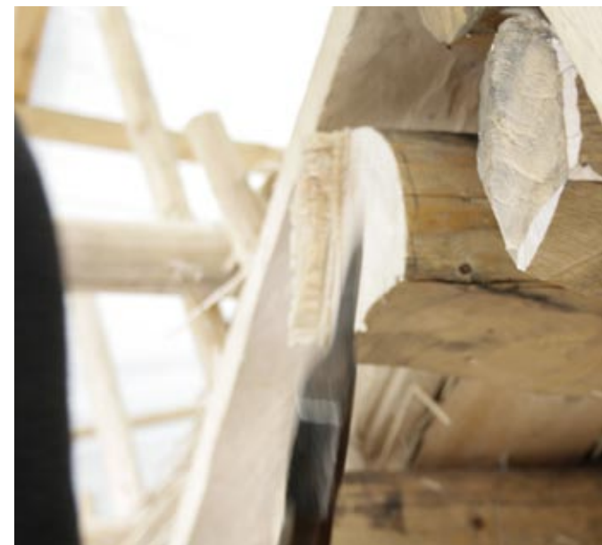
Sarvilautojen alta työntyvät vuoliaisten pääet lyhennettiin, jotta päätyihin voidaan myöhemmin asentaa otsalaudat.
