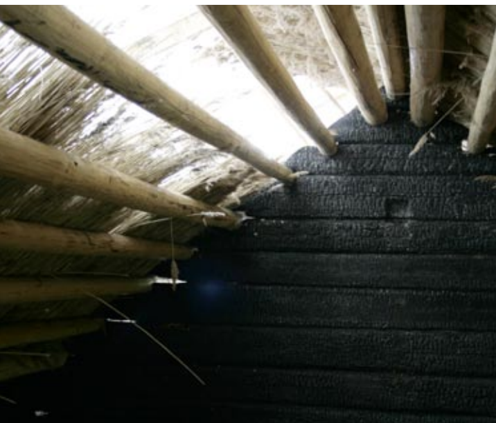
Aitan sisäpuolella palossa hiiltynyt pinta jätettiin sellaisenaan näkyviin.
