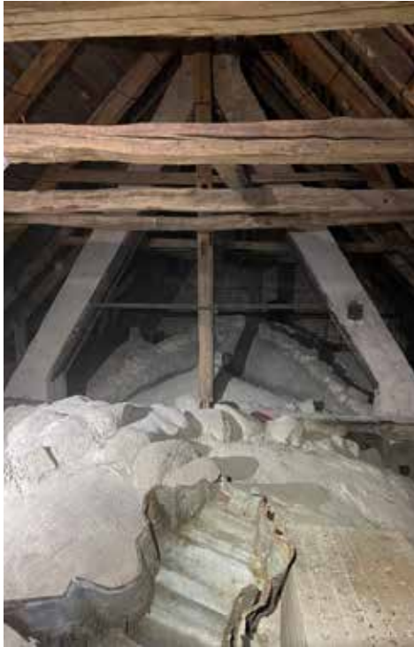
Näkymä runkokuoneen vintiltä, holvien yläpuolelta. Kitapuissa näkyy vanhoja liitosten lovia, joiden alkuperä ei ole selvillä.
