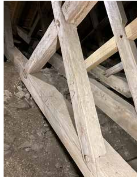
Runkokuoneen kattotuolin pohjoispuolen merkintä. 5 + 2 = kattotuoli 7.
