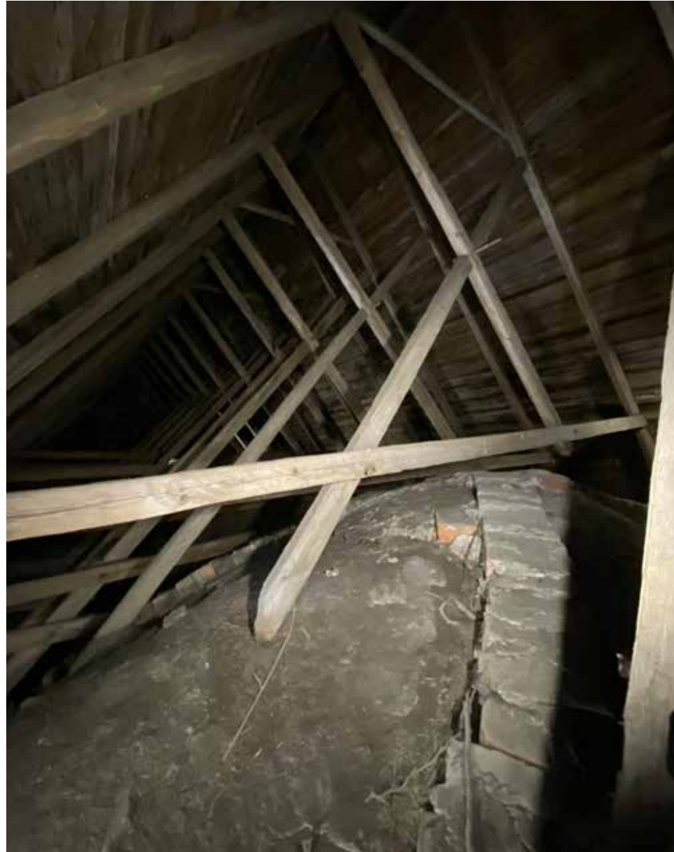
Holvien päällä ei ole eristeitä. Osa saksista on katkaistu alapäästä holvien rakentamisen yhteydessä.
