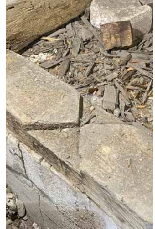
Sisemmässä jalasparrussa on X-lapaliitos kohdassa, jossa aiemmin on kaiketi sijainnut alapäärre. Liitoksen tekemisessä on mahdollisesti käytetty käsisahaa.
