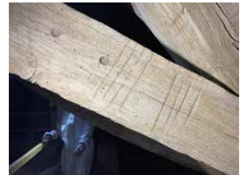
Läpiporausjälkiä ja viivanumerointeja.
