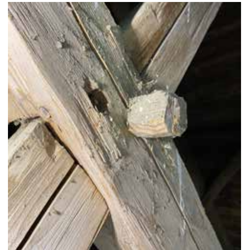
Tapin vieressä on läpiporausjälki.
