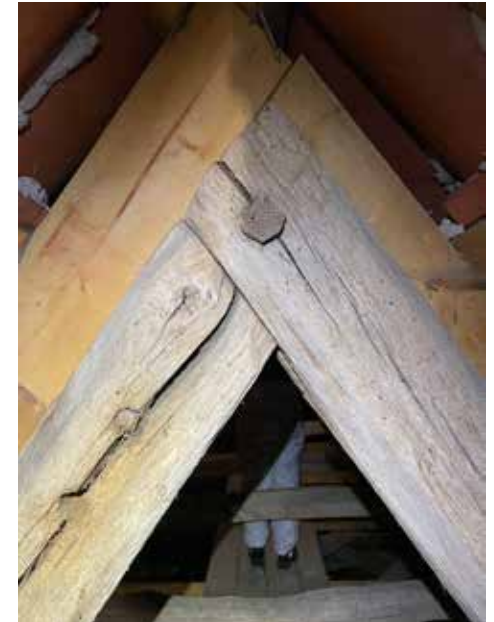
Selkäpuiden liitos harjalla. Kattotuolien harjaliitosten alapuolella on runsaasti kairauskoloja. Kolut vaarnajäänteineen saattavat liittyä kattotuolien kokoamiseen pinossa, jolloin ne on liitetty tapeilla toisiinsa, mutta ne voivat myös kertoa kattotuoleissa käytetyn puutavaran lauttauksesta.
