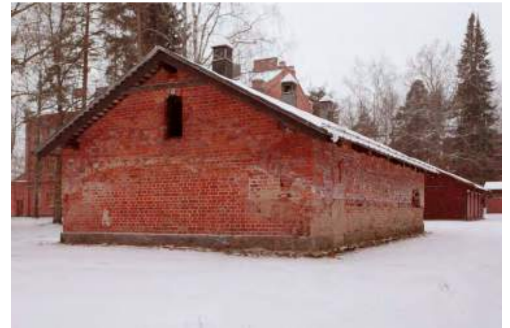
Venäläisaikaisen varaston (13) kulmissa näkyy halkeamia.
