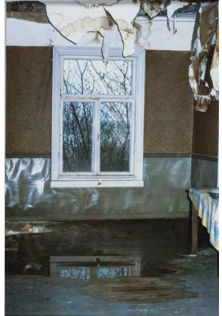
Ruokasali 1970-luvulla, kun katolta valui yläpohjan läpi vettä. Kuvassa näkyy vielä rakennuksen suhteen pitkittäissuuntainen, uudempi laualattia. Kuva: MV.
