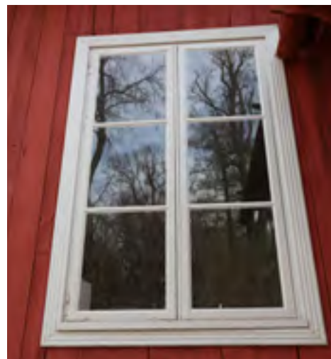
Kuusiruutuisten ikkunoiden toiseen ulkopuoliseen tehtiin ulkopuoliset kulmaraudat ja saranakulmaraudat, toiseen puitteeseen niitä ei tehty. Kuvassa on keittiön h13 ikkuna.
