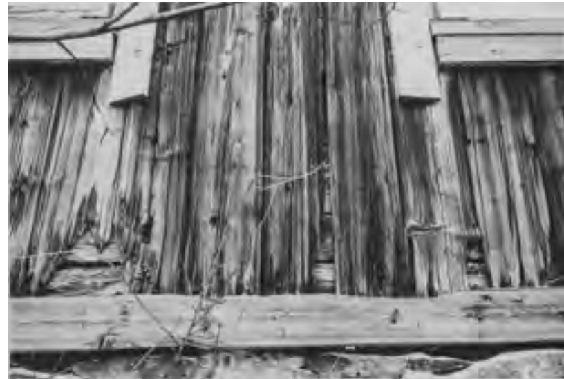
Sään kuluttamaa kaakkoissivun ulkovuorausta. Kuva: MV.
