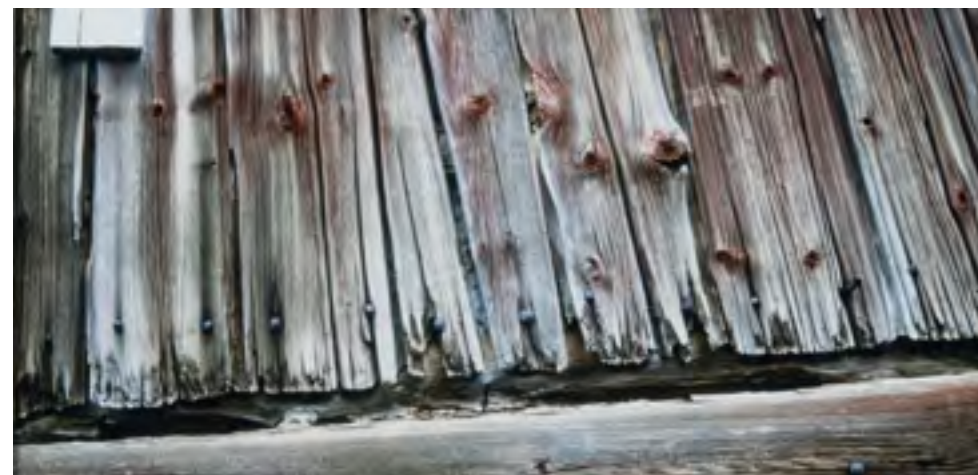
Kaakkoissivun ja lounaispäädyn ulkovuoraus oli vuonna 1978 pahasti auringon, sateen ja tuulen kuluttamaa. Kuva on mahdollisesti kamarin h6 tai h7 kaakkoissivun ikkunan alta, jossa vanha laudoitus oli ponttien säilytyessä irti harventunut reiälliseksi. Kuva: MV.
