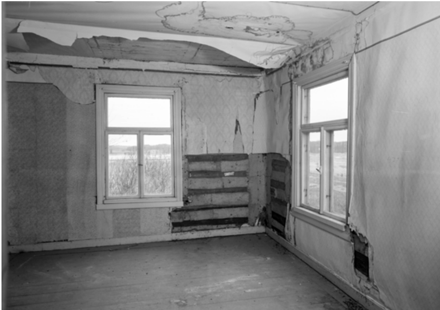
Kulmakamari h6 vuonna 1978. Seinärakenteita on avattu. Hirsiraot ovat peitettyjä. Katossa ja seinissä on vesivaurioita. Kuva: P. O. Welin / MV.
