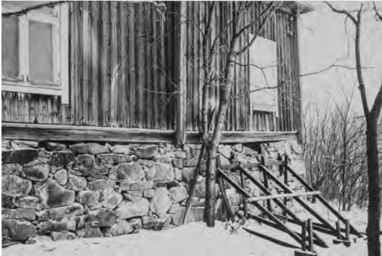
Pullistuvaa kivijalkaa tuettiin vuonna 1977 tilapäisillä tukirakenteilla. Kuva on lounaispäädyistä. Kuva: MV.
