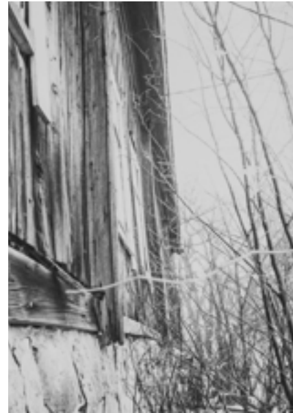
Kaakkoisseinän pullistuma. Kuva: MV.
