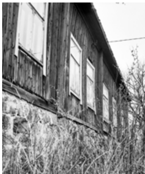
Kaakkoisjulkisivu oli notkahtanut sisäänpäin. Kuva: Veijo Laine 1974 / MV.
