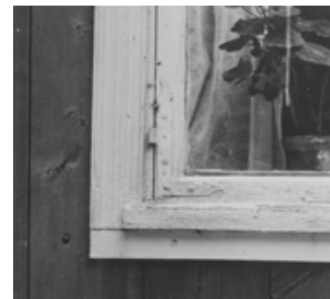
Kuistin ikkunan saranakulmaraudasta puuttuu saranatappi vuonna 1966. Kuva: Elias Härö / MV.
