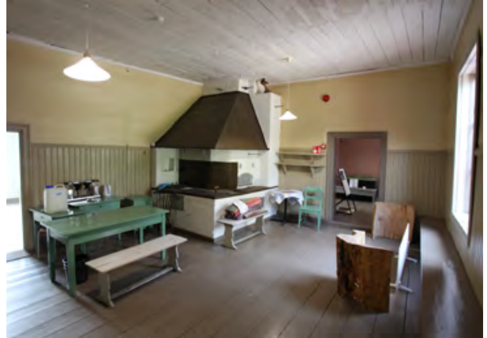
1980-luvulla hella valkaistiin. Lattialaudoitus uusittiin, kattolevyt poistettiin ja kattolaudoitus maalattiin. Kattolaudoituksessa on sauma ja paikkapaloja. Kuva on toukokuulta 2022.
