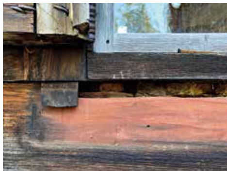
Rakennuksen julkisivujen viimeisin punamulta- käsittely lienee 1800-luvulta.
