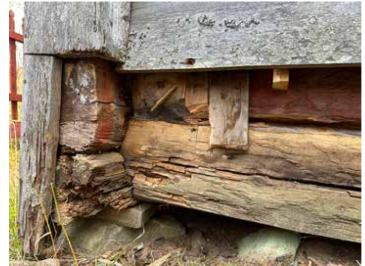
Uusi lahovaurio nurkalla 4-3.
