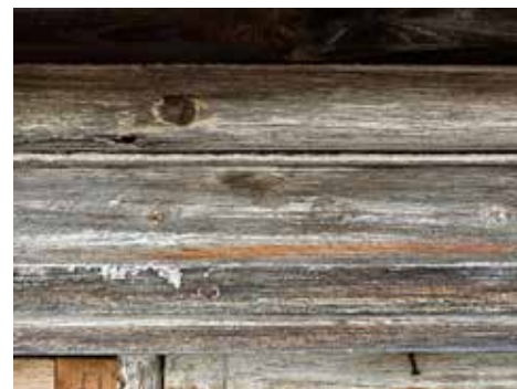
Eteläsakaran oven yläpuolisen ikkunan ylävuorilistassa on näkyvissä jäänteitä maalista.
