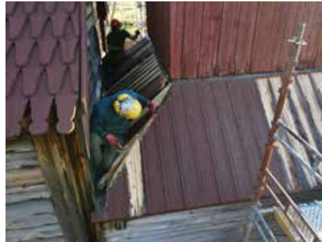
Lautakатteen lahovaurioita tapulin pohjois- ja itäisivuilla.
