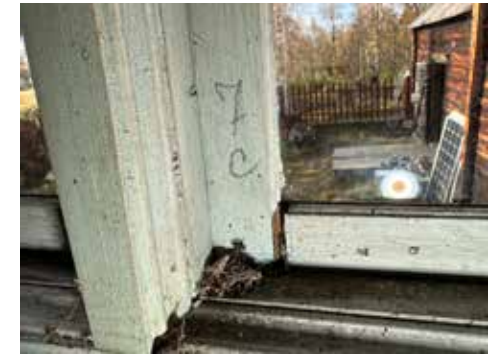
Auennut puite ikkunassa 9.
