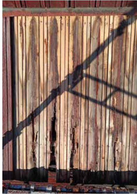
Alemman lautakerroksen lahovaurioita tapulin eteläisivulla.
