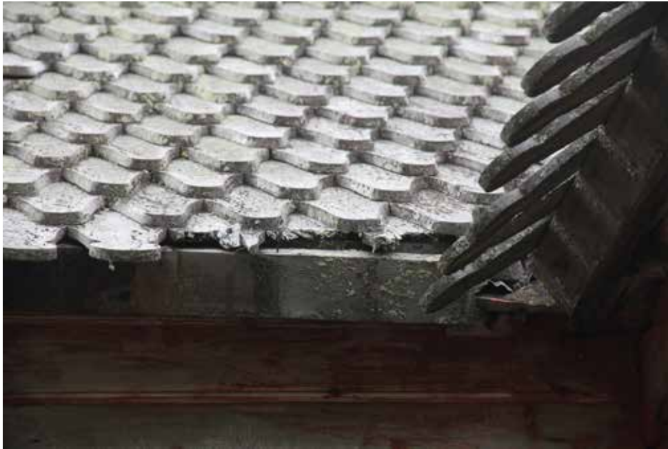
Räystäspanujen vaurioita kesällä 2024. Kuva Tuomo Rinne.
