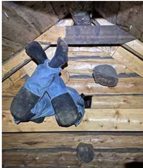
Ristikeskuksen vinttiin pääsee itäsakaran sisäpäätykolmioon puhkaistusta kulkuaukosta. Vuoden 1959 leikkaukseen merkittyä toista aukkoa ei ole.
