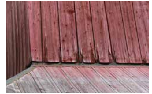
Kellotapulिन yläosan lautaverhouksen vaurioita kesällä 2024. Kuva Tuomo Rinne.
