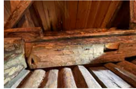
Kellotapulिन katelaudoituksen lahovaurioita kesällä 2024.
