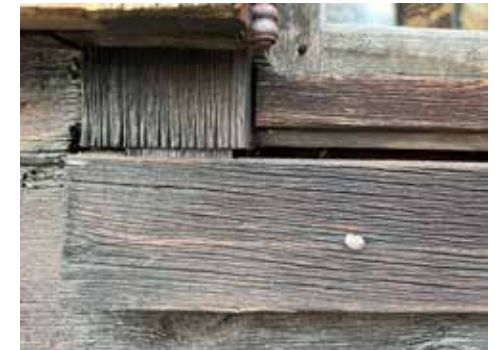
Ikkunan 8 alavuorilista on tippunut paikaltaan ja alakarmista on lohjennut pala.
