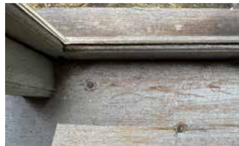
Ikkunoiden sisäpuoliset maalipinnat ovat hiutuneita ja krakeloituneita.
