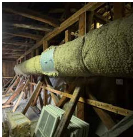
Holvin etelä- ja pohjoispuolella on suuret vaakasuuntaiset ilmanvaihtoputket. Kuva on eteläpuolelta länteen päin.
