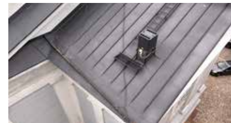
Pohjois-, länsieteisten ja itäpuolisen kuorin katoilla on paikalliset poistoilmalaitteet.
