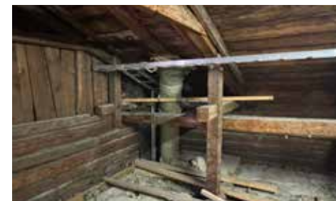
Ullakkotilan läpi kuoriin menevä poistoilmaputki.
