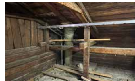
Ullakkotilan läpi kuoriin menevä poistoilmaputki.
