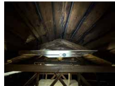
Vuorilautoja on mahdollisesti vaihdettu paikoissa, joista painovoimaisen ilmanvaihdon ”Wolpertin imuhatut” ovat aiemmin puhkaisseet vesikaton.
