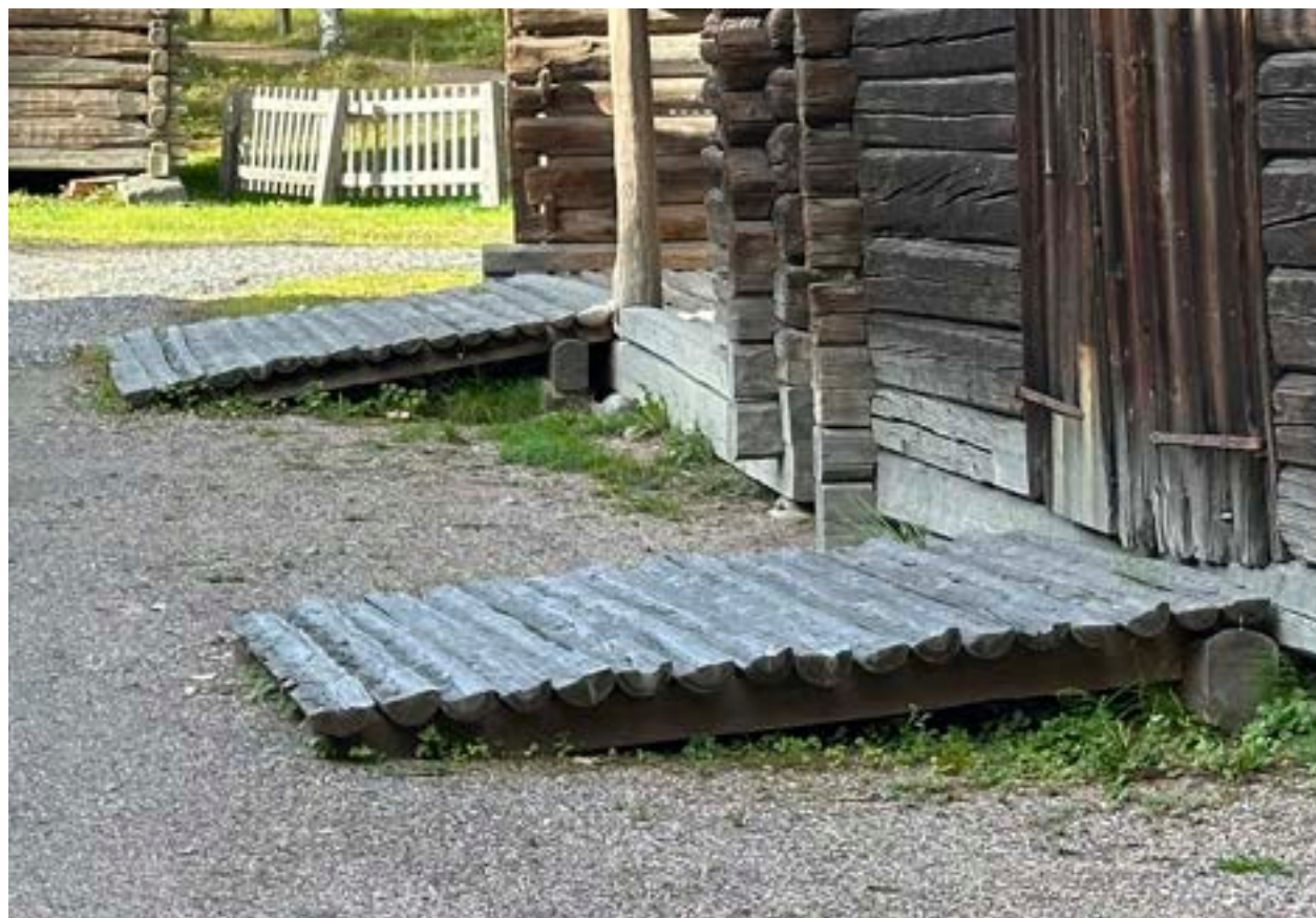
Ratahuoneiden rampit harmantuneina vuonna 2025.
