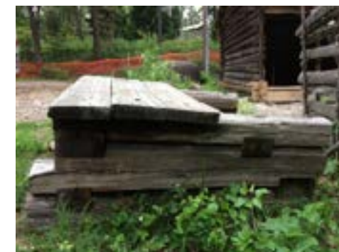
Vuonna 2021 salvosporras muistutti paljon alkuperäistä mutta oli korjauksen tarpeessa.
