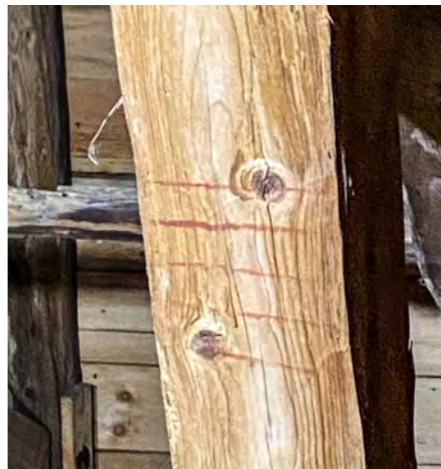
Punakynämerkkintöjä runkokuoneen uudemmissa kattotuoleissa.
