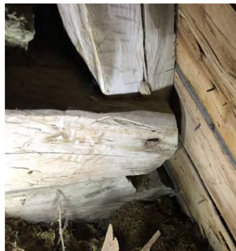
Selkäpuun suora lapaliitos alapaarteeseen on tehty samalla tavalla kuin pönkän liitos alapaarteeseen: liitos ei ulotu alapaarteen läpi, vaan ehjää alapaarretta jää loven alapuolelle.
