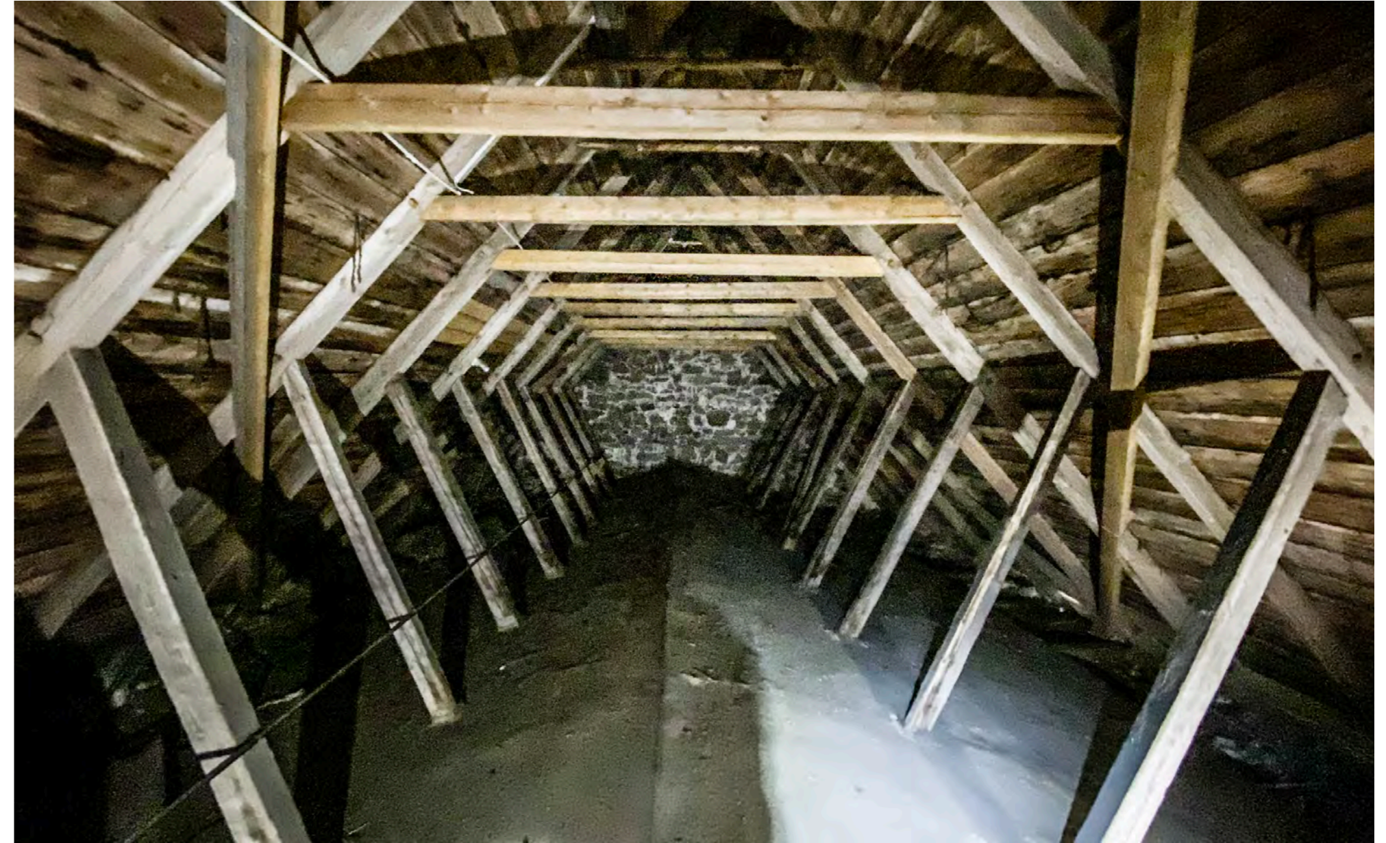
Näkymä vintille. Kattorakenteen alaosassa on bitumikatteella päällystetty välikatko, jonka päältä mahdollinen vesi valuu muureille.
