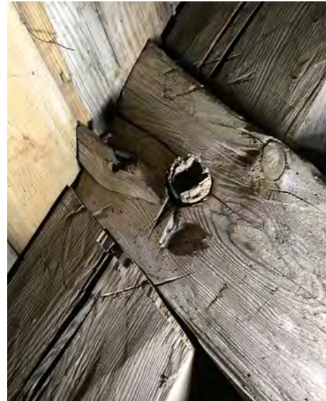
Selkäpuun ja pönkän liitos. Liitostappi on lyöty vastakkaiselta puolelta kuin kattotuoli on koottu. Tapin vieressä näkyy läpiporausjälki. Liitosmerkit jatkuvat rakennusosasta toiseen.
