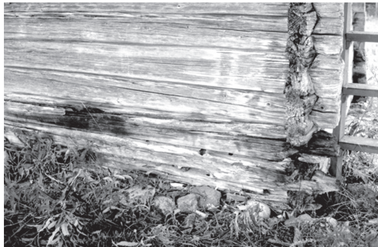
Uotunaitan lahovaurioita (kss)
